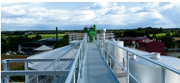
Zwei zentralgerührte Fermenter mit Zentralrührwerk Two continuous stirred tank reactors with central stirring system
