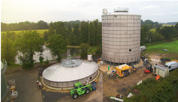
Anheben des Behälters mit Hubstützen Lifting of the tanks with lifting supports
